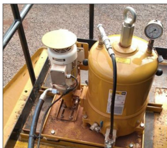
Um dos filtros de óleo CJC® instalado nos 6 caminhões de transporte.
